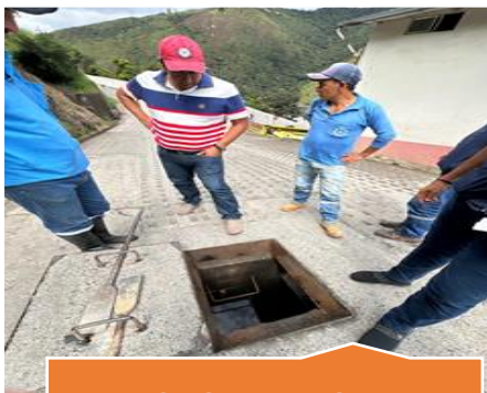
MACROMEDIDOR DE SALIDA
