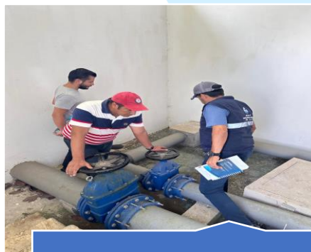
ESTADO DE VALVULAS
